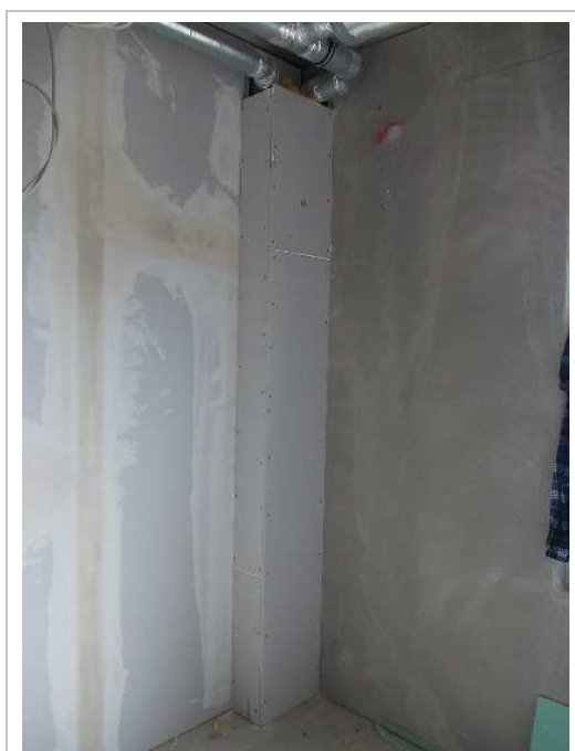
Rysunek 4.5 Zabudowa przewodów instalacyjnych
