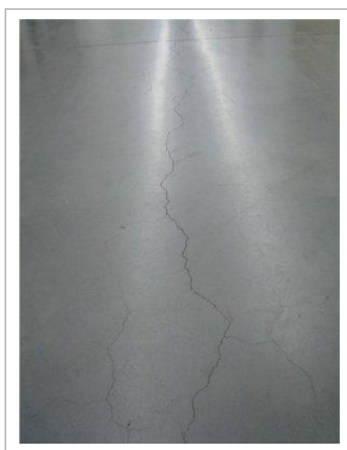
Rysunek 8.3 Typowe pęknięcie posadzki
