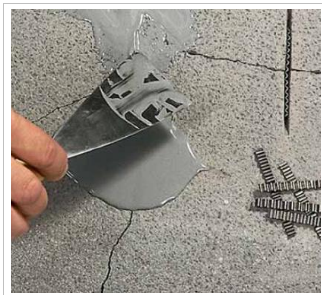
Rysunek 8.1 Pęknięcia posadzki
