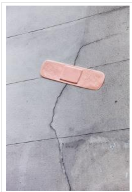
Rysunek 8.3 Uszkodzenie tynku
