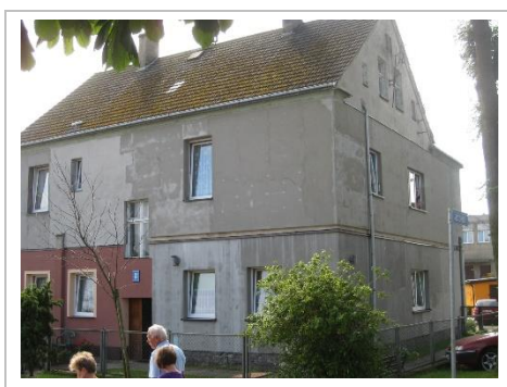
Rysunek 8.8 Źle wykonany tynk na dociepleniu
